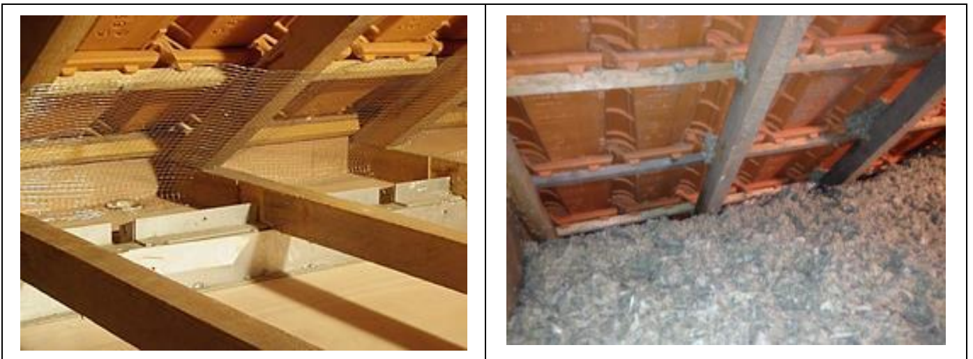
Figure 19 : Vue d'ensemble du grillage installé, avant (gauche) et après (droite) soufflage de la laine de roche
